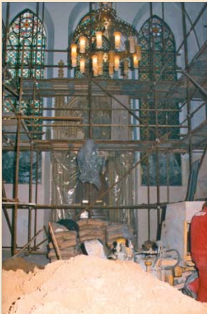
Oprava a rekonstrukce interiéru Maiselovy synagogy. V rámci stavebních prací byla provedena oprava topení, obnova dlažby a byly restaurovány historické prvky interiéru (zábradlí, okna, galerie atd.).
